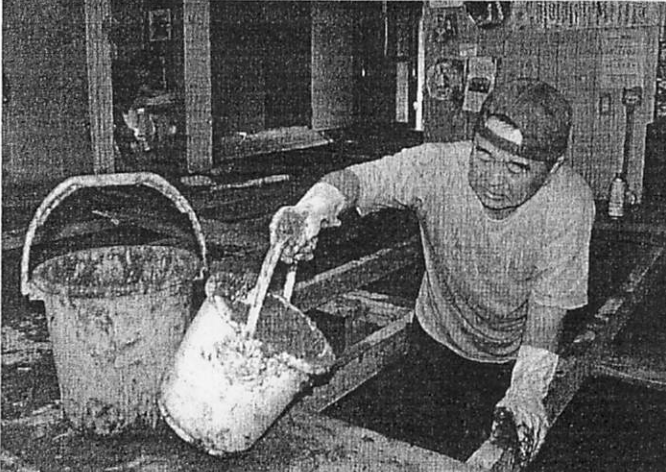
床上約30センチまで浸水した家屋。友人らの手伝いで軒下の泥搬出が行われていた＝6日、同町嘉入
